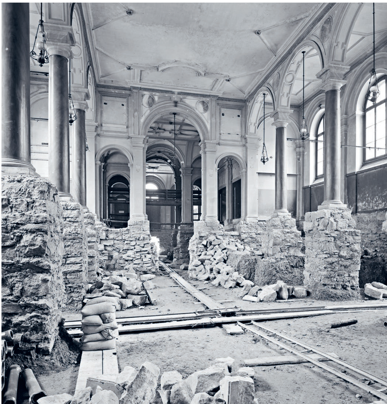
Blick auf die Haupthalle der ETH Zürich während des Umbaus durch Gustav Gull (1915).
