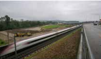
Mauern sind abgetragen und Bohrer sind zurückgezogen, um das Areal für die künftigen Bauarbeiten vorzubereiten. © Flavia Nüssli
