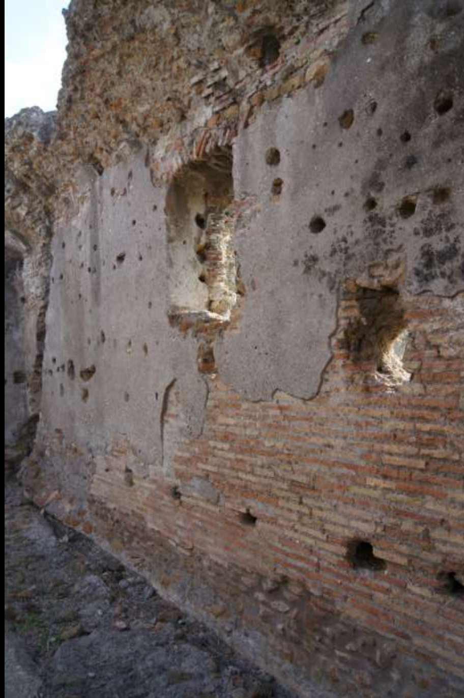
Rom, Wasserreservoir mit wasserdichtem Putz (Opus signinum), Villa dei Quintili (2. Jh. n. Chr.)
