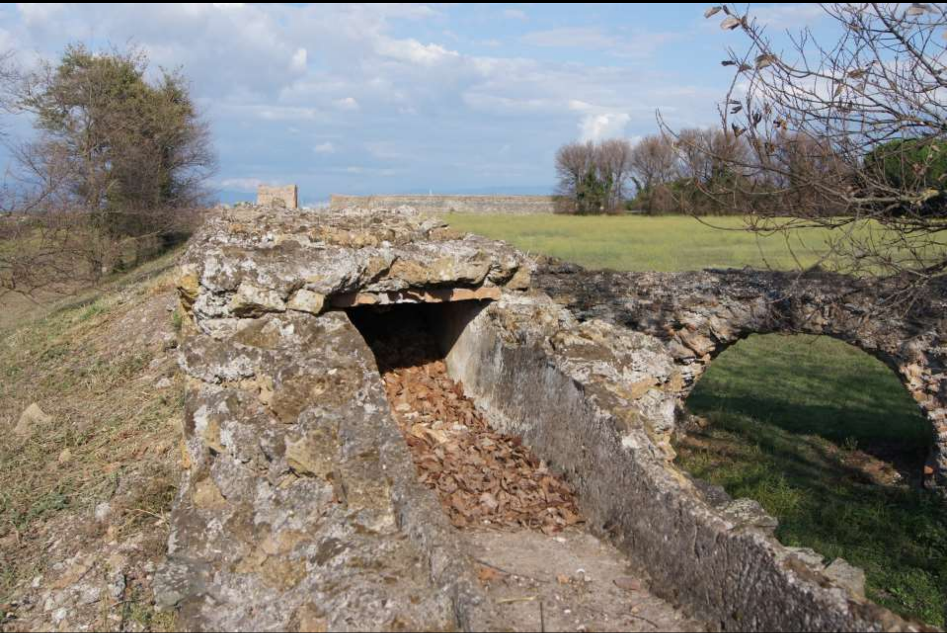
Rom, Wasserzuleitung zur Villa dei Quintili (2. Jh. n. Chr.): Wasserkanal, mit wasserfestem Putz gedichtet
