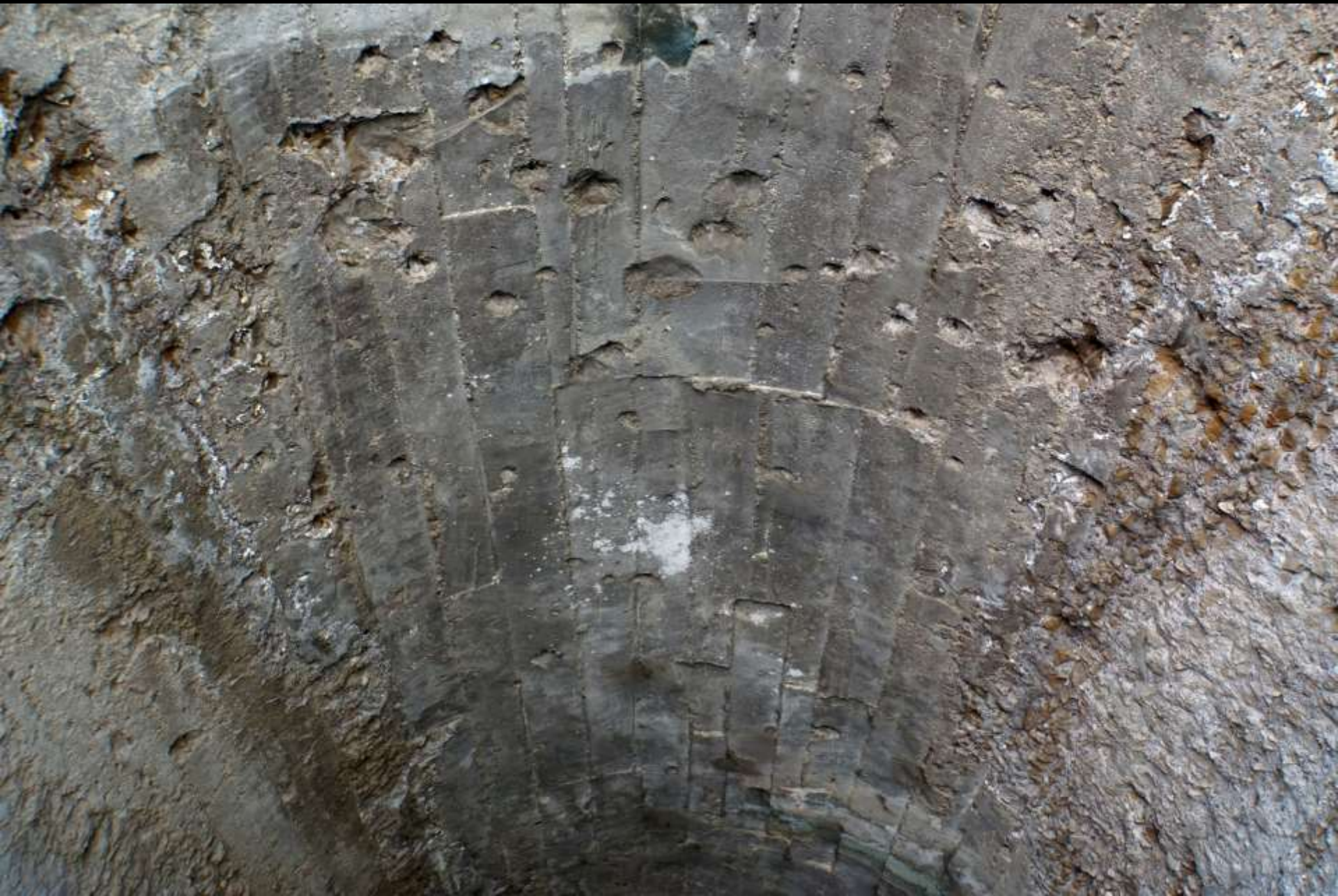
Abdrücke der Schaldbretter an einem Tonnengewölbe (Tivoli, Villa Adriana, 2. Jh. n. Chr.)
