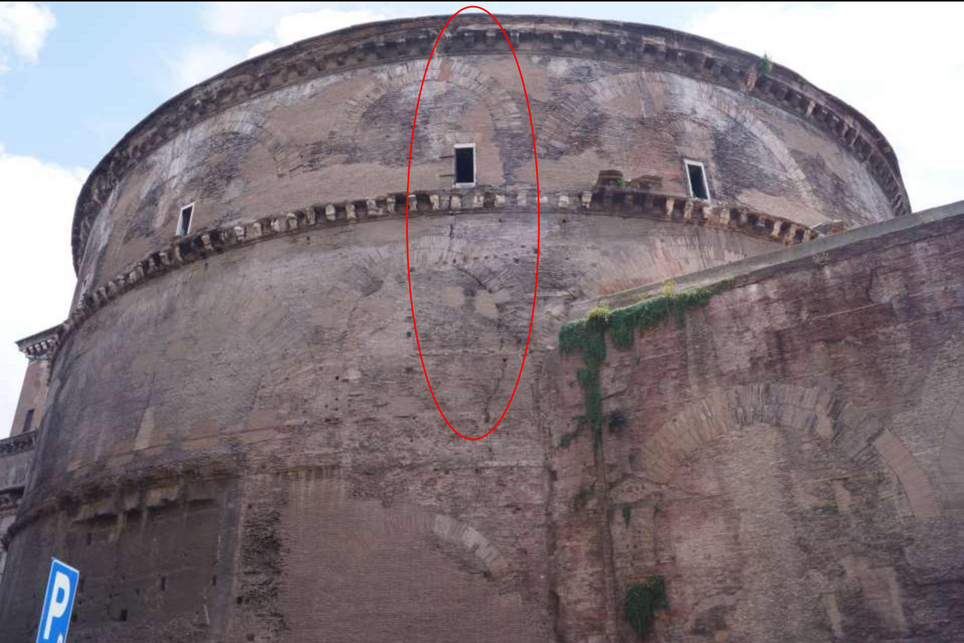
Rom, Pantheon. Aussenbau der Rotunde mit Rissen
