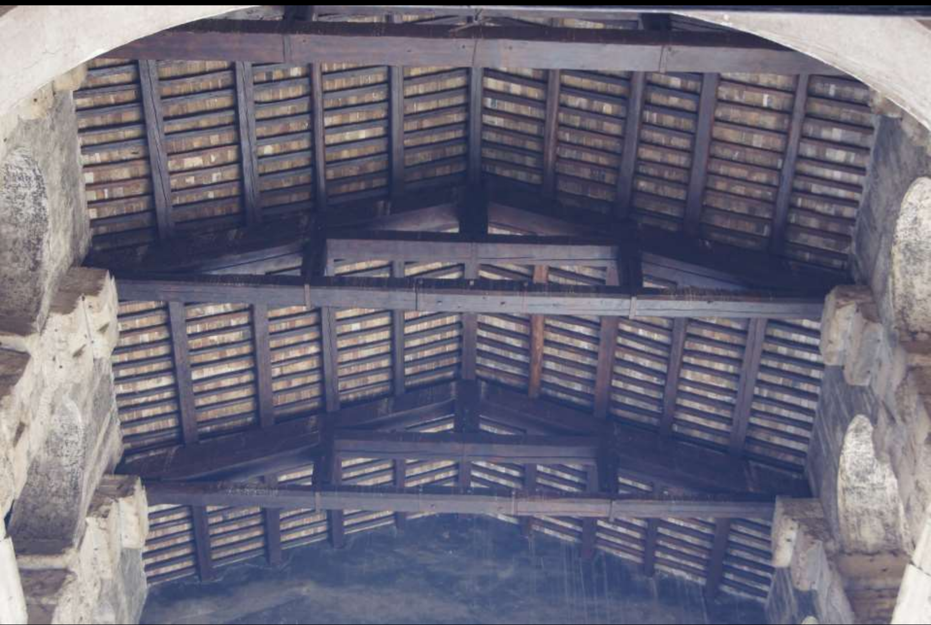
Rom, Pantheon. Portikus. Blick ins heutige Dachwerk (17. Jh.) „... quod non fecerunt Barbari, fecerunt Barberini ...“
