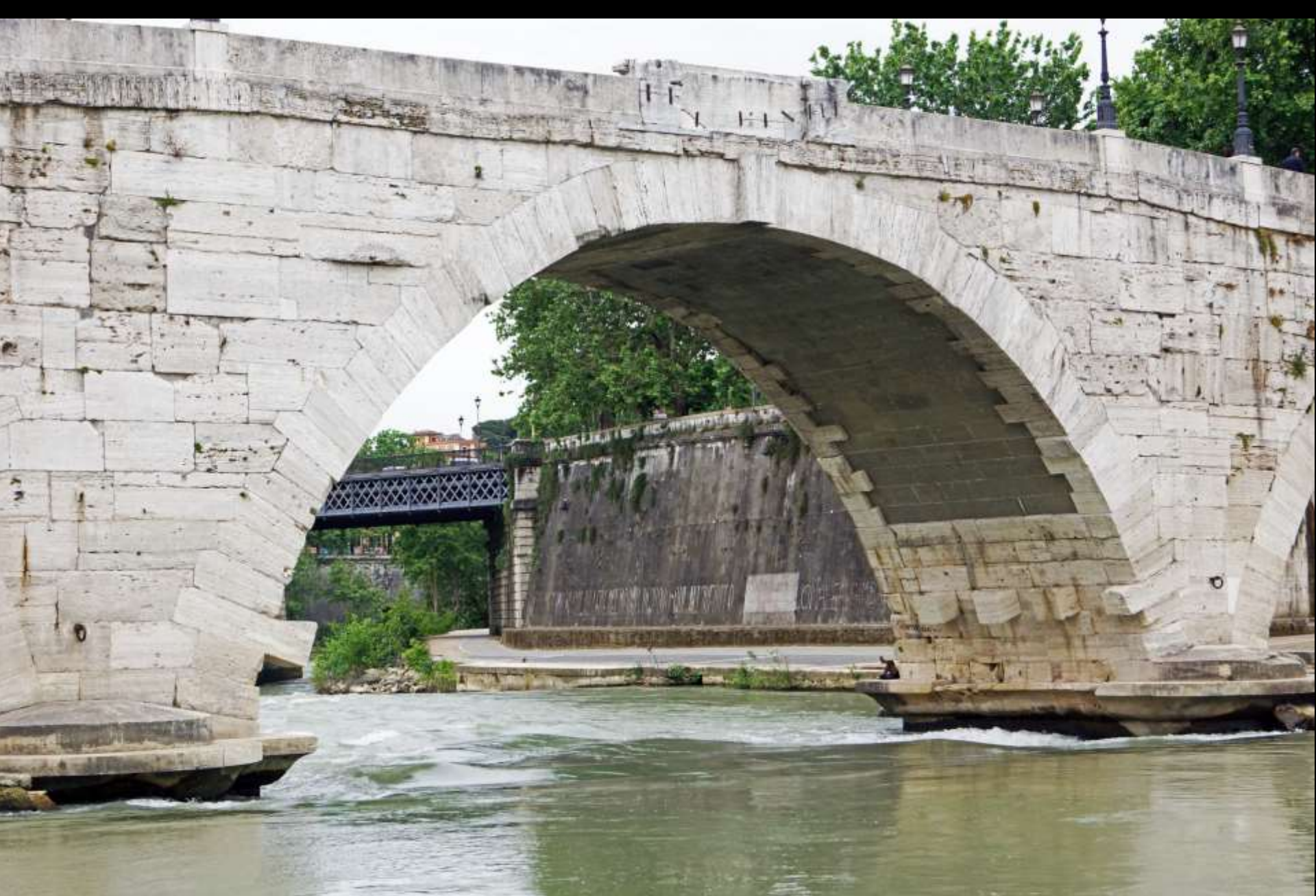
Kragsteine als Auflager für Lehrgerüst (Rom, Pons Cestius, 4. Jh. n. Chr. und restauriert im 19. Jh.)
