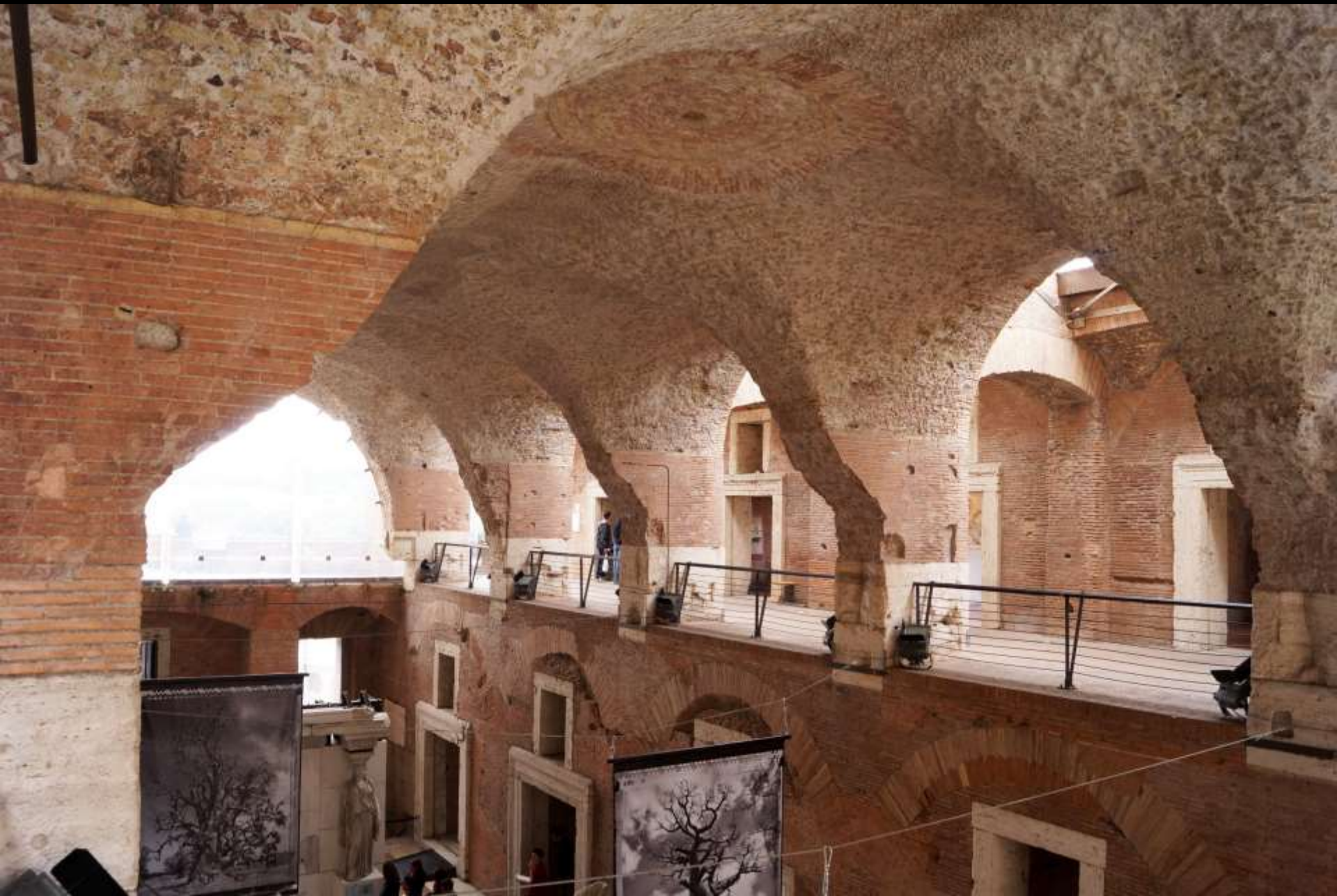
Kreuzgewölbe aus opus caementicium (runder Bereich in der Mitte ist Restaurierung eines Loches!) (Rom, Traiansmarkt, 2. Jh. n. Chr.)
