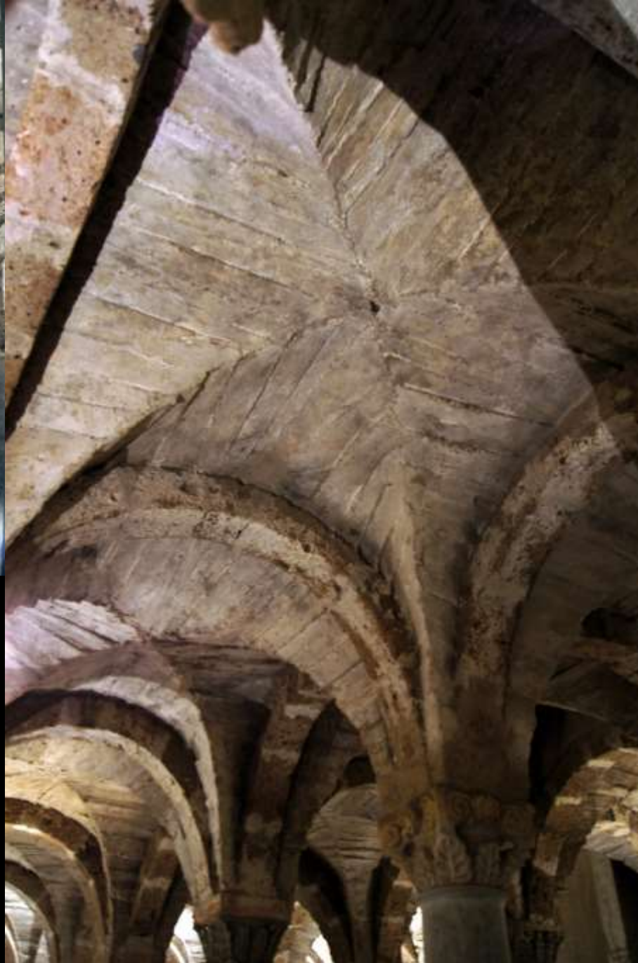
Sutri (Latium), Dom, Krypta (12. Jh.). Schalbrettspuren
