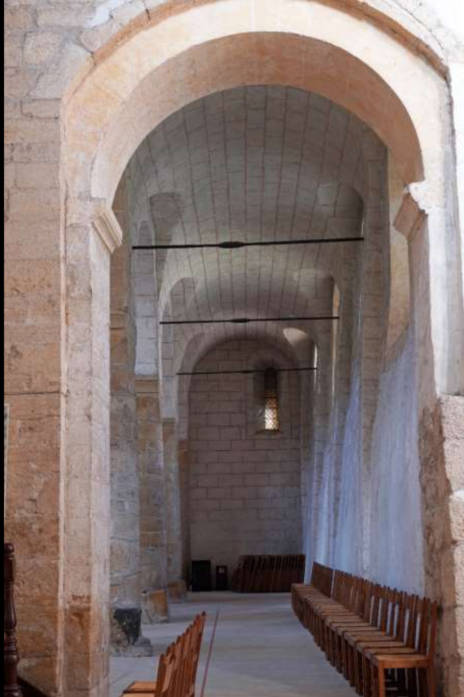
Romainmôtier, Abteikirche. Ausweichen der Seitenschiffswand wegen Schub des Tonnengewölbes
