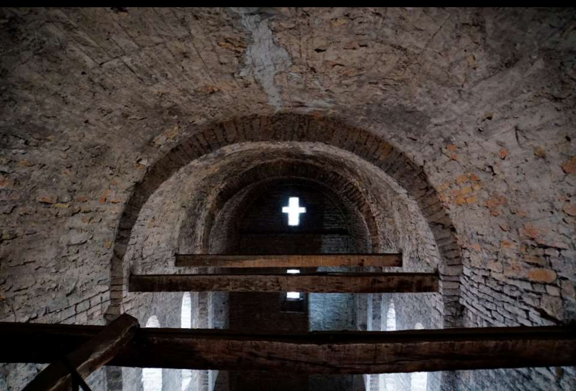
Tournus, Saint-Philibert. Vorkirche, Obergeschoss. Tonnengewölbe und Zuganker im Mittelschiff. (Foto: Louis Vandenabeele, IDB)
