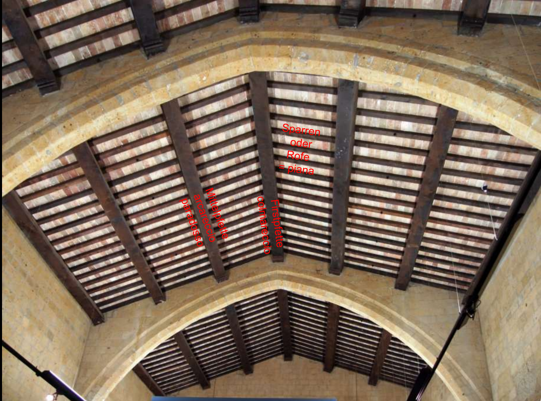
Dach als „schräger Boden“ (Orvieto, Palazzo Papale). Aus dem Unterzug wird eine „Pfette“
