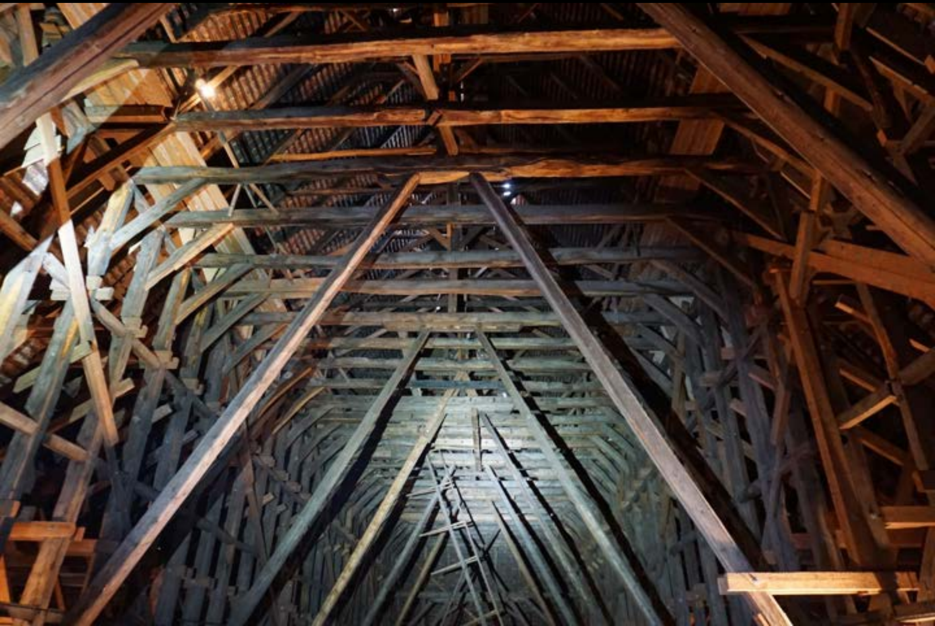
Braunschweig, St. Ägidien. „Aufgeständertes Kehl balkendach“ mit Ständerwand unter den Kehl balken.
