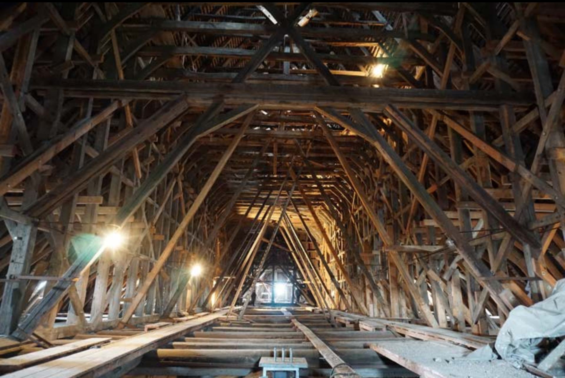
Braunschweig, St. Ägidien. „Aufgeständertes Kehl balkendach“ mit Ständerwand unter den Kehl balken.
