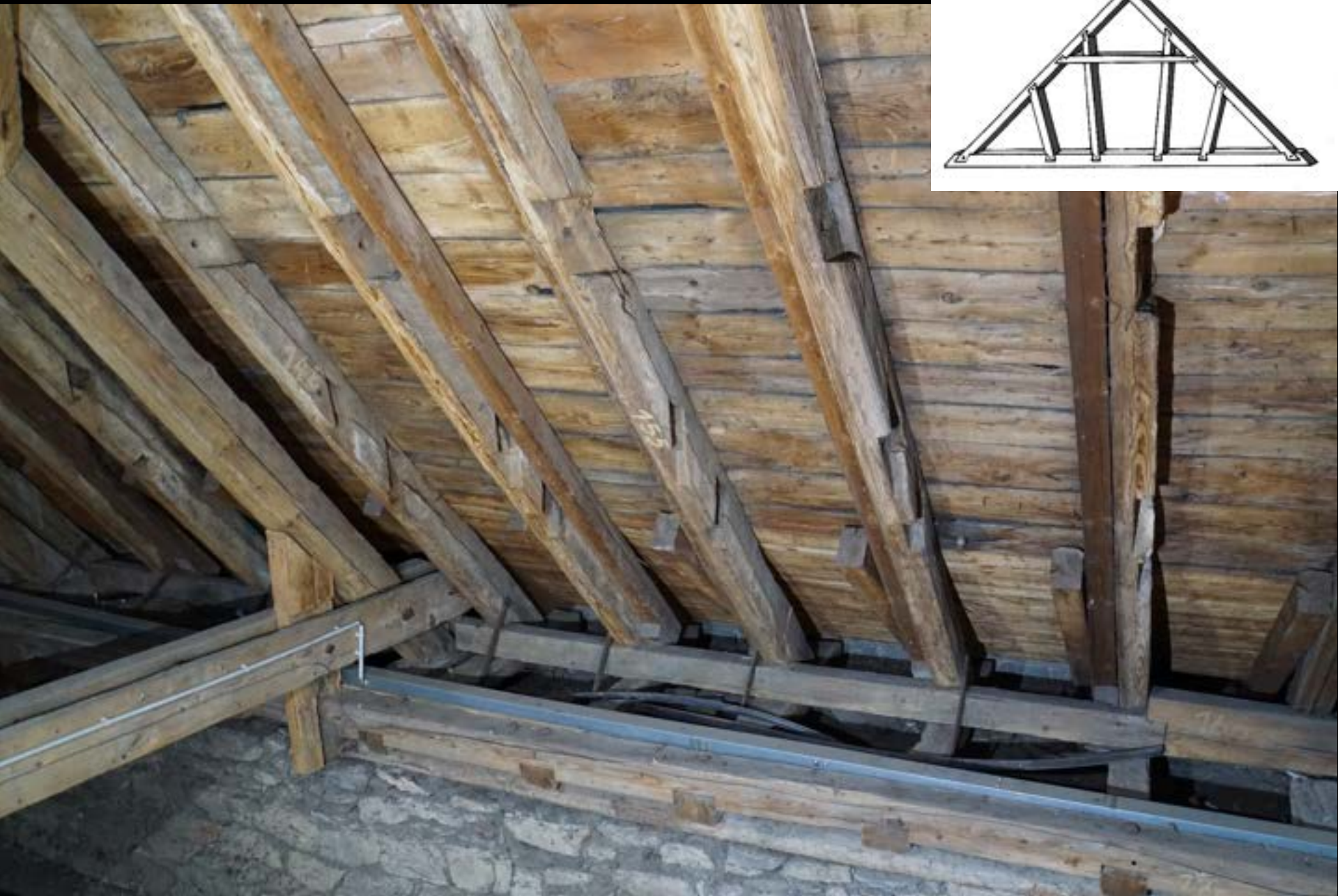
Relikte eines Dachwerks mit Kehlbalken und mehreren Sparrenknechten (Limburg/Lahn, Dom, Südquerhaus, um 1220)
