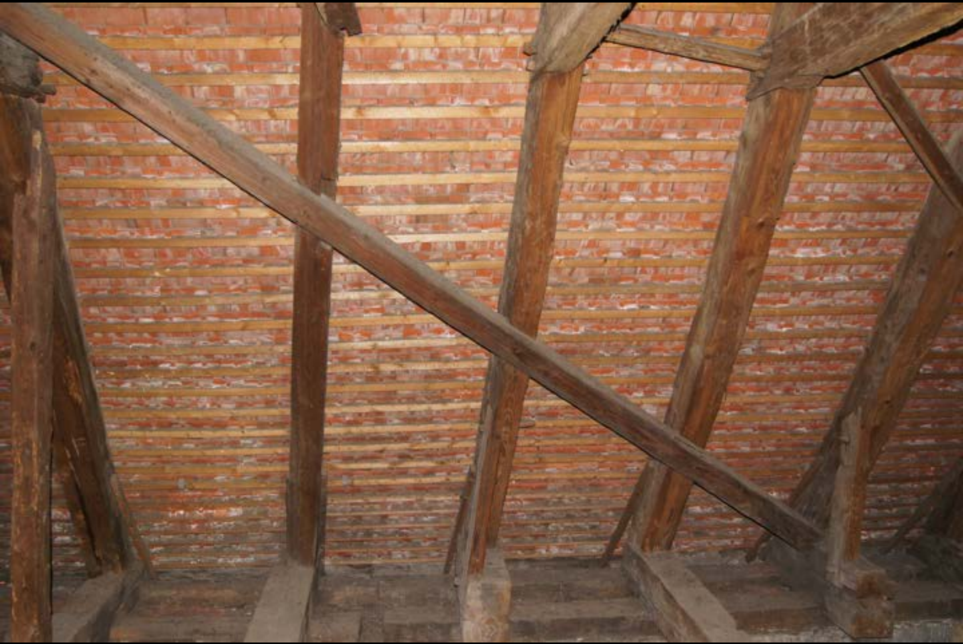
Erfurt, Predigerkirche, Langhaus (13. Jh.): schiefstehende Gespärre und Windrispe
