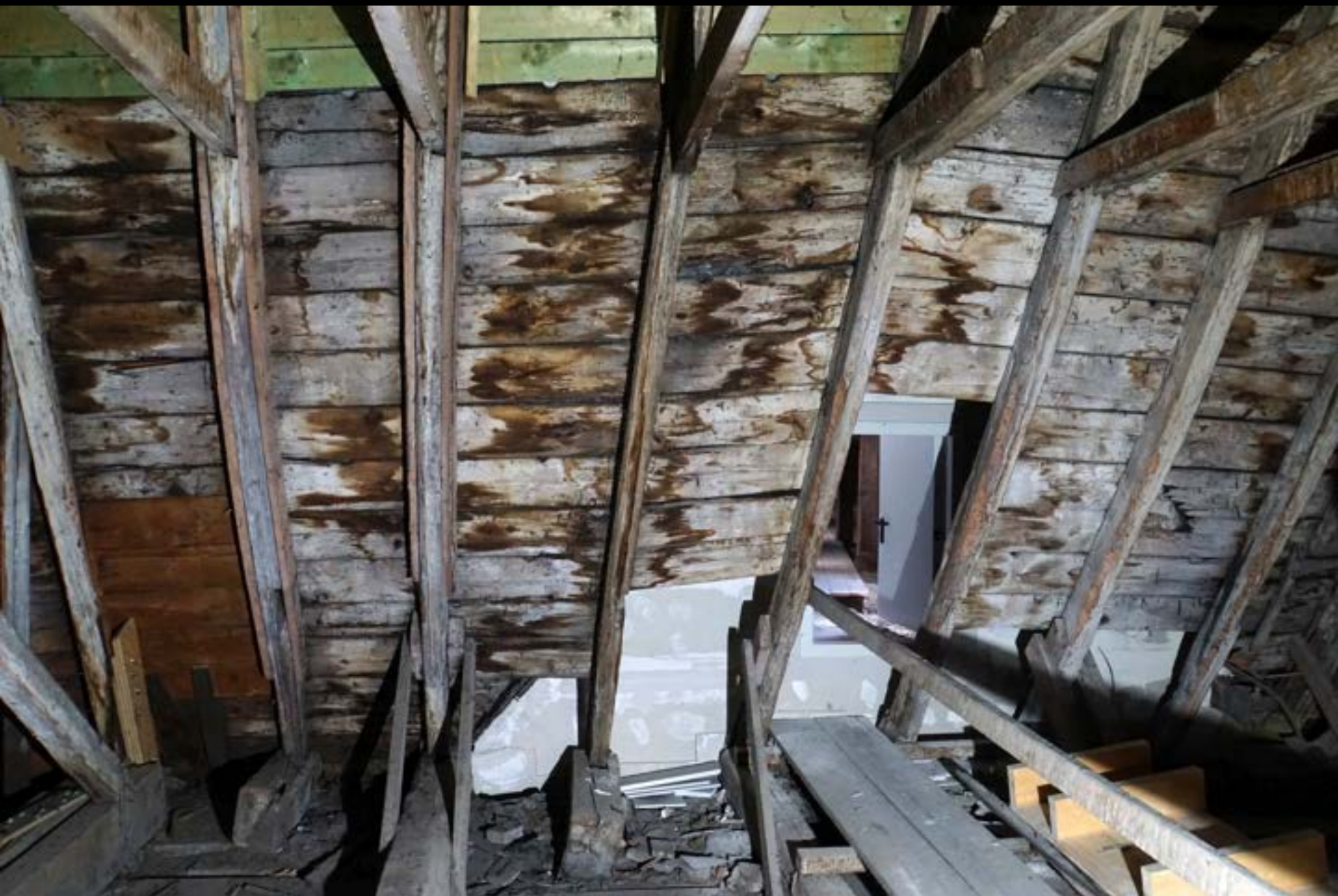
Limburg/Lahn, Annenkirche (14. Jh.), schiefstehende Gespärre infolge fehlender Längsaussteifung
