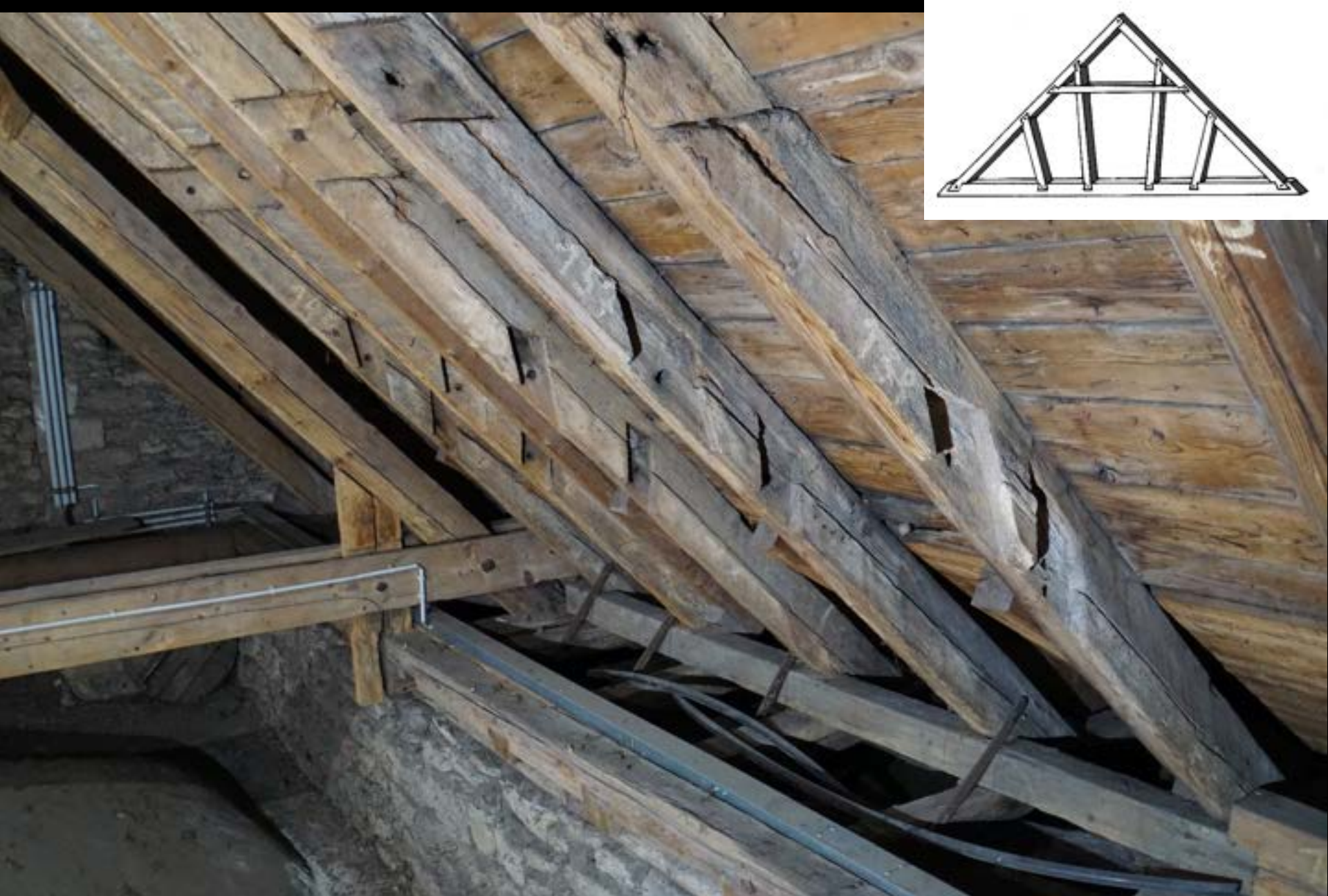
Relikte eines Dachwerks mit Kehlbalken und mehreren Sparrenknechten (Limburg/Lahn, Dom, Südquerhaus, um 1220)
