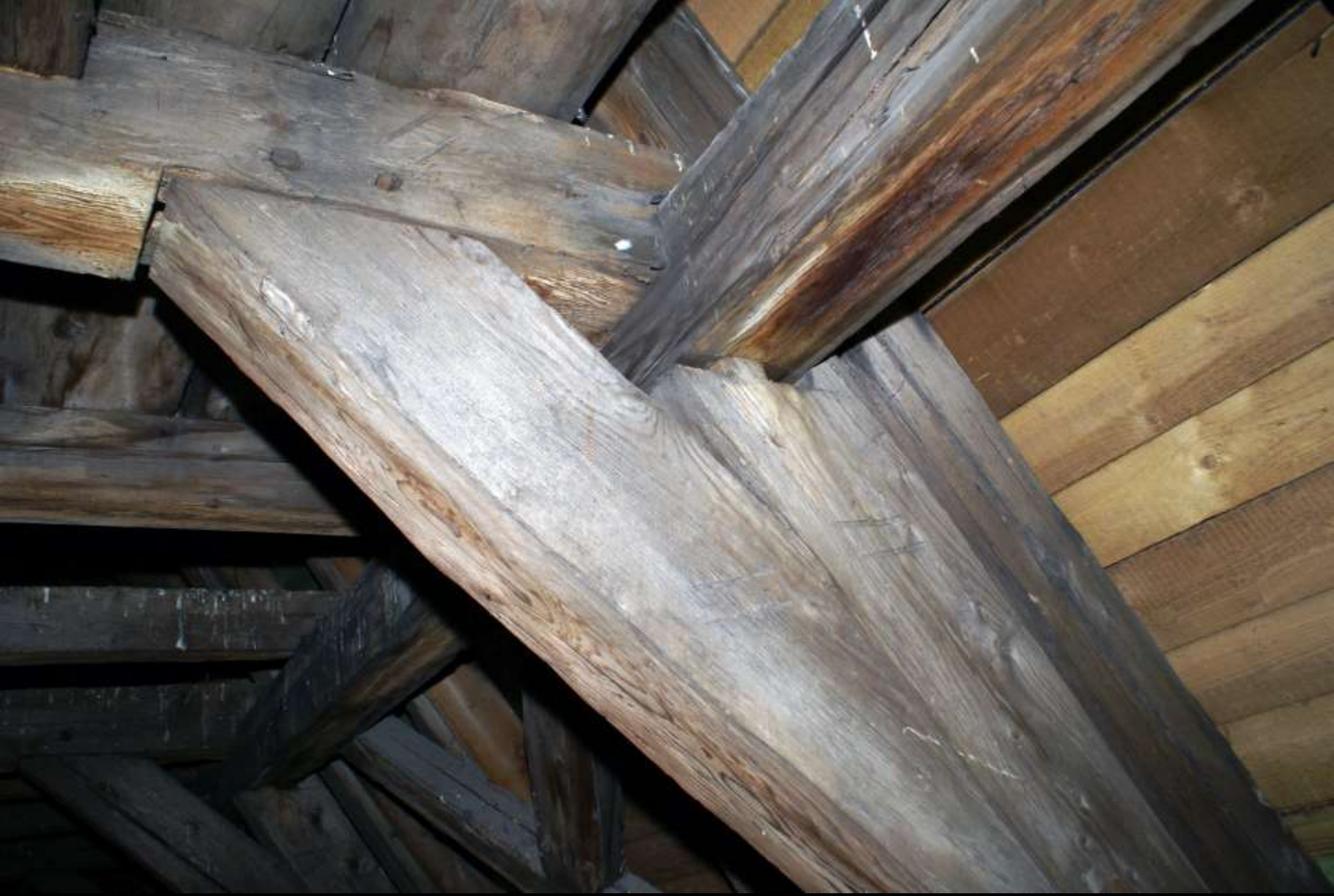
liegender Stuhl: Sonderformen – Rechteckkrähm und Stuhlsäule mit schräg zur Faser geschnittenem Zapfen Spannriegel fehlt (Salvatorkirche München, Ende 15. Jh.)
