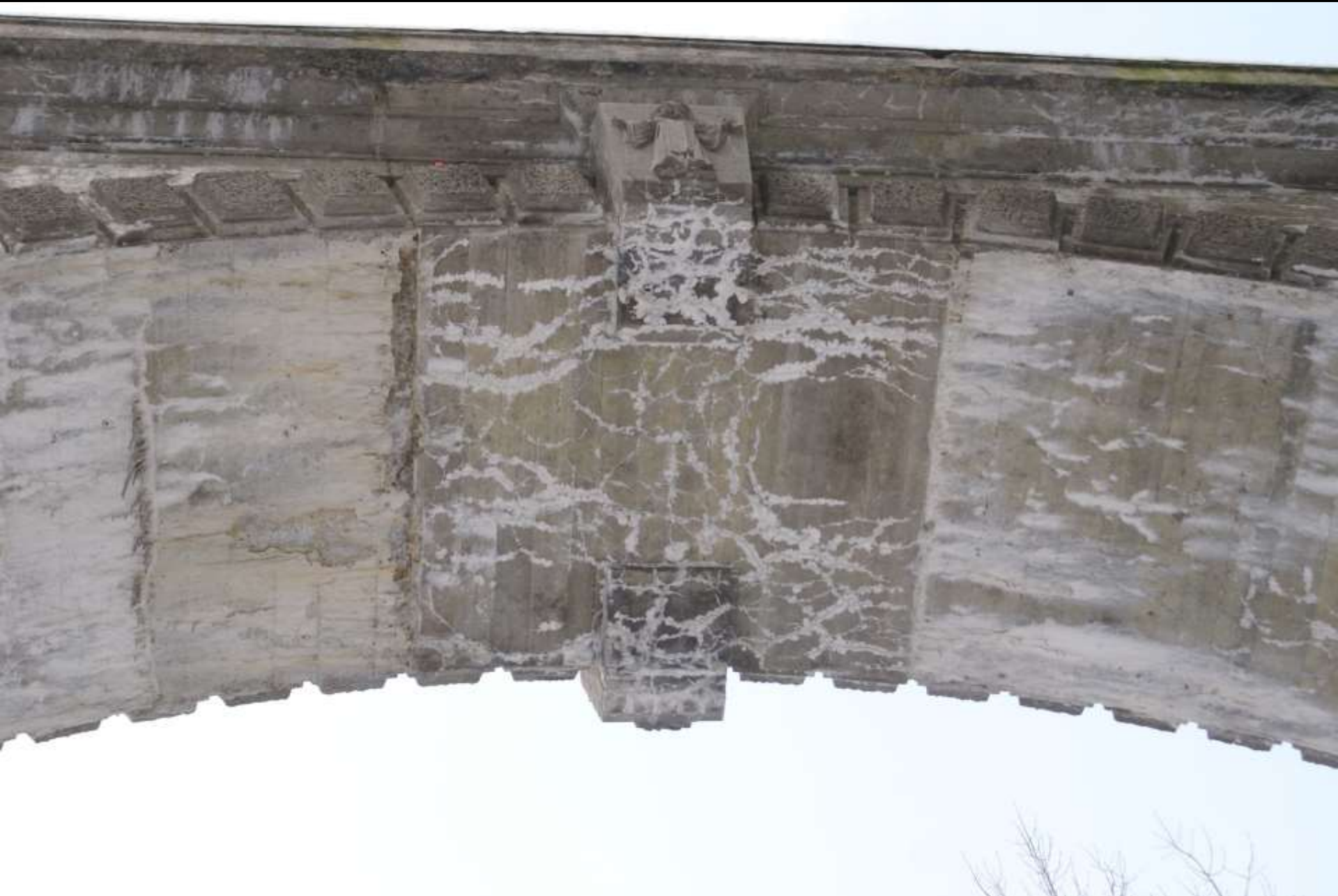
Ein erster Vor-Ort-Besichtigungstermin (13. Februar 2010): Befunde .... Doch was sehen wir hier eigentlich?
