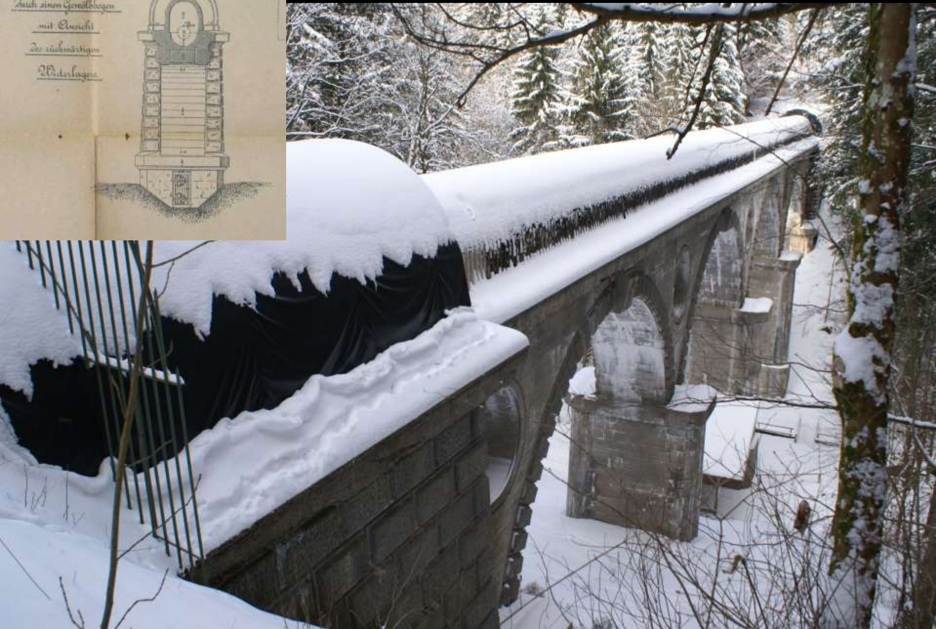
Ein erster Vor-Ort-Besichtigungstermin (13. Februar 2010) ... das Gewölbe wurde durch Wellblech ersetzt ...
