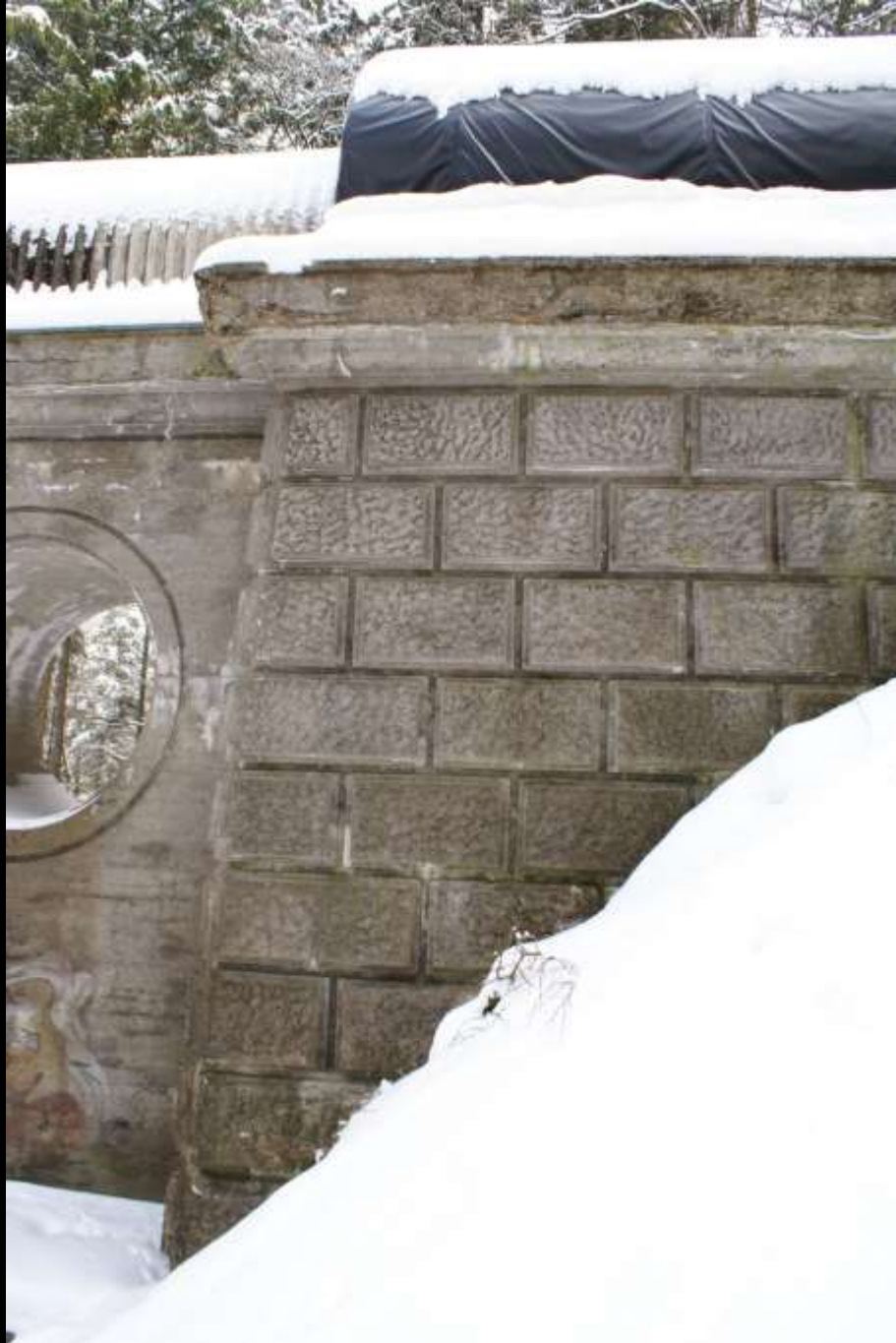
Ein erster Vor-Ort-Besichtigungstermin (13. Februar 2010): Befunde .... Doch was sehen wir hier eigentlich?
