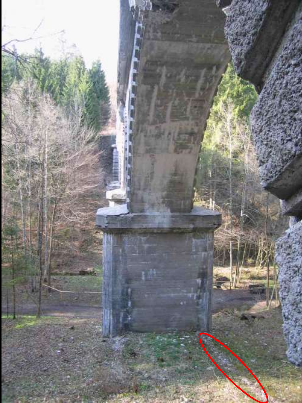
Es bröckelt ... (24. April 2010) (... aber primär vom Gesims!)
