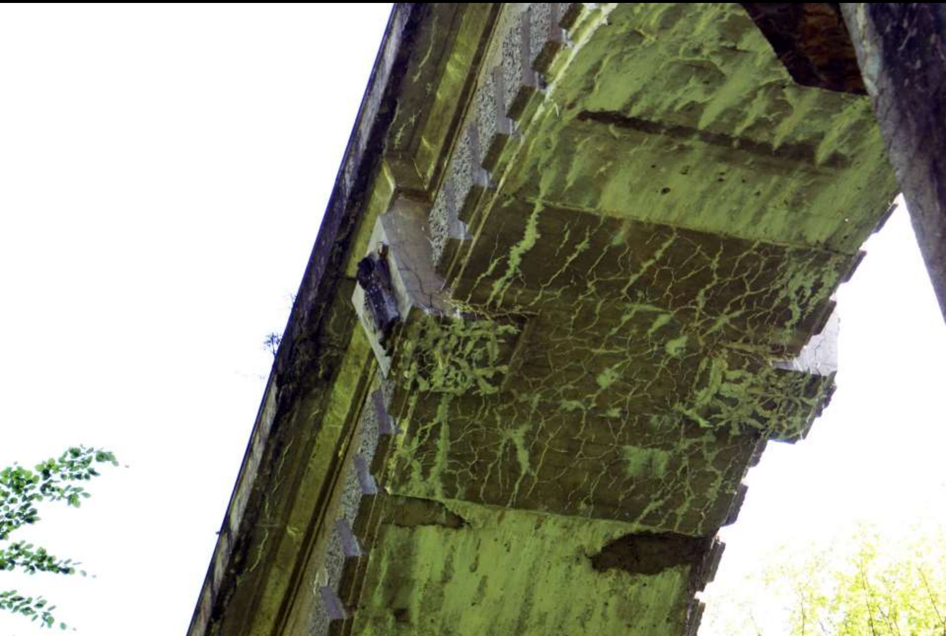
... Schäden ja, aber Einsturzgefahr? (Juni 2008)
