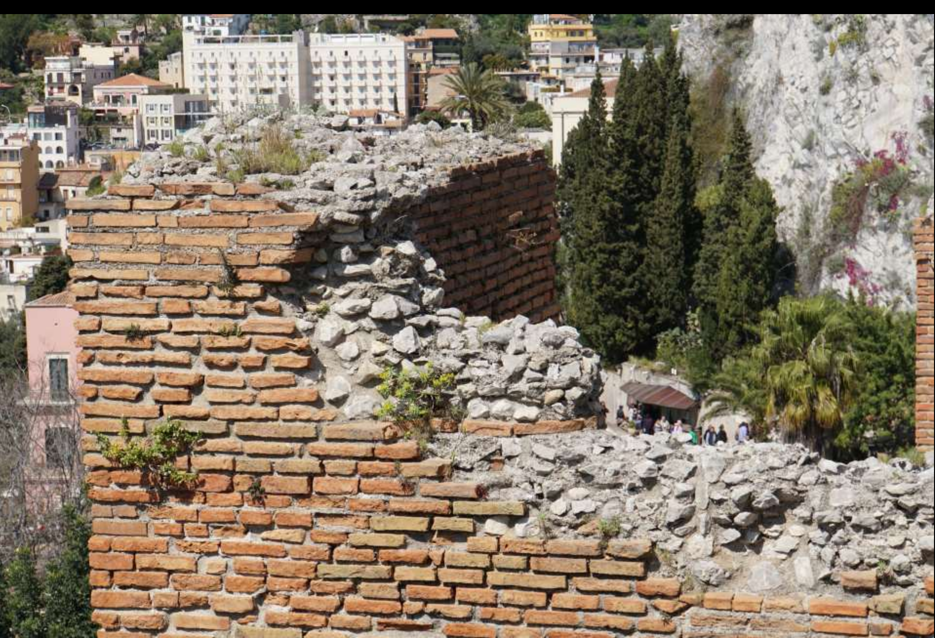
Opus testaceum : Bruchstein mit „verlorener Schalung“ aus Ziegeln (Kaiserzeit) (römisches Theater, Taormina/Sizilien)
