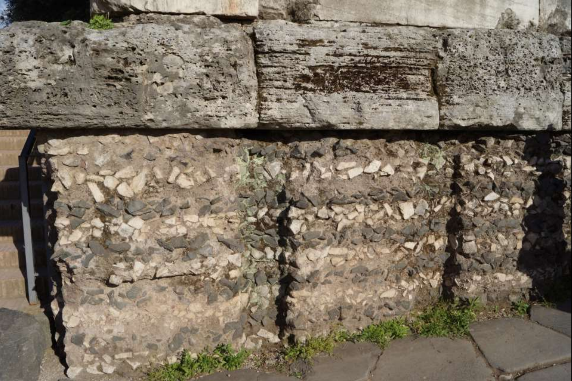
Ursprünge des opus caementicium: Fundamente Bruchsteinfundament mit Spuren der Baugrubenschalung (Rom, Titusbogen, Fundament, heute fälschlich freiliegend)
