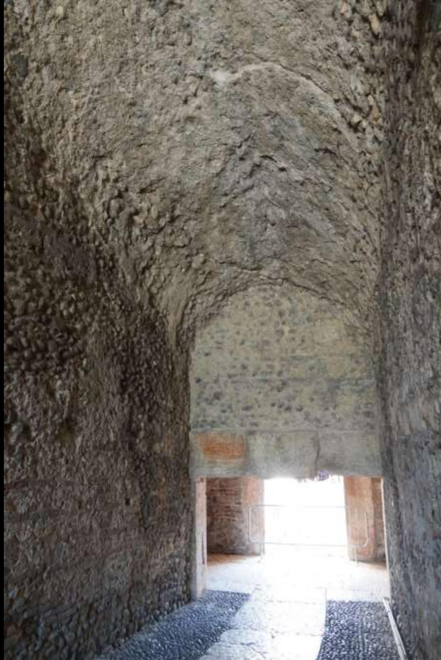
Amphitheater: Verona (1. Jh. n. Chr.): Gewölbte Konstruktionen aus opus caementicium unter der cavea
