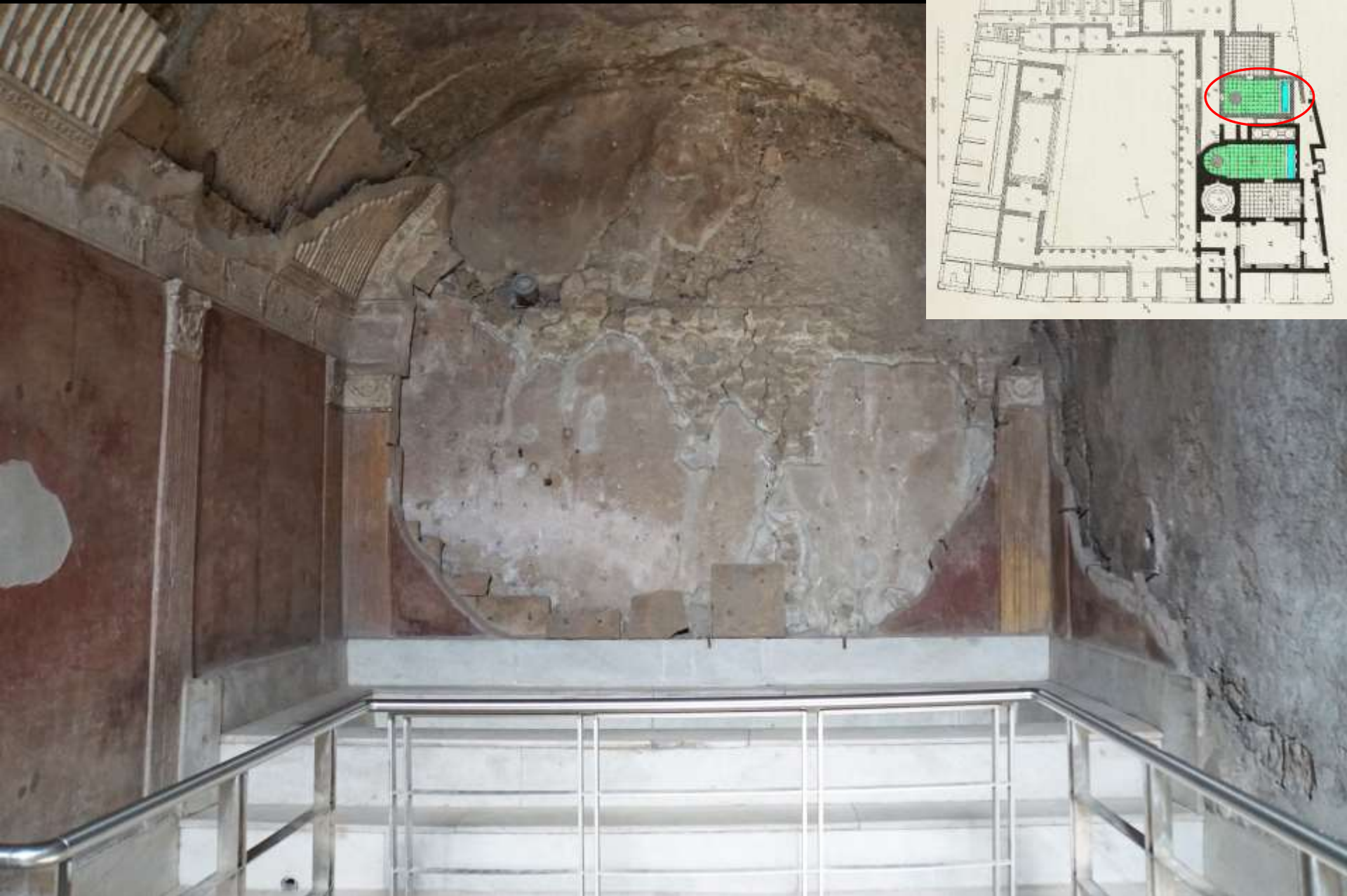
Stabianer Thermen in Pompeji: Caldarium des Frauenbads mit alveus (Wanne) (Foto: J. Schäfer)
