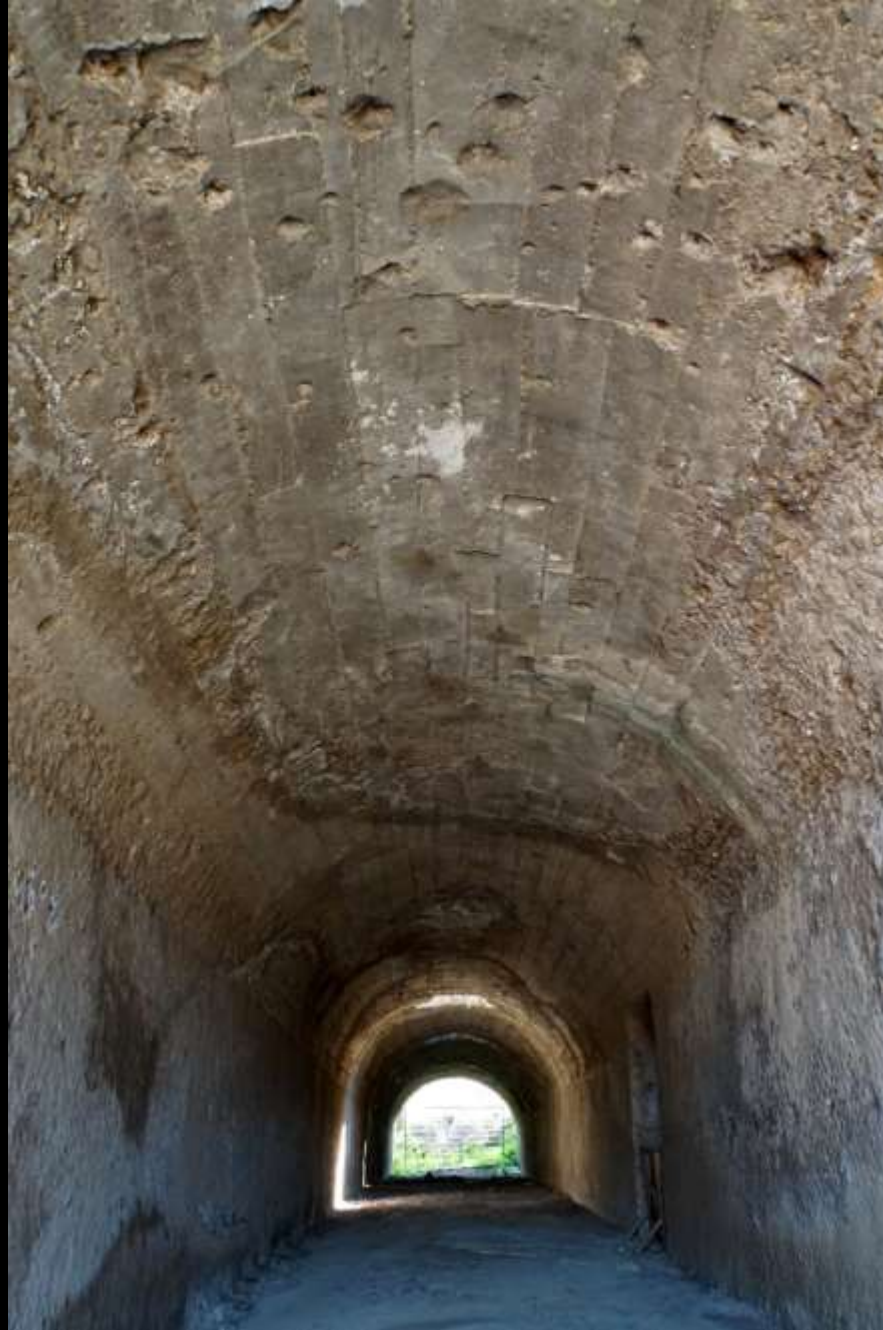
Tonnengewölbe aus Bruchstein ganz ohne Verstärkungsurte (Tivoli, Villa Adriana, 2. Jh. n. Chr.)
