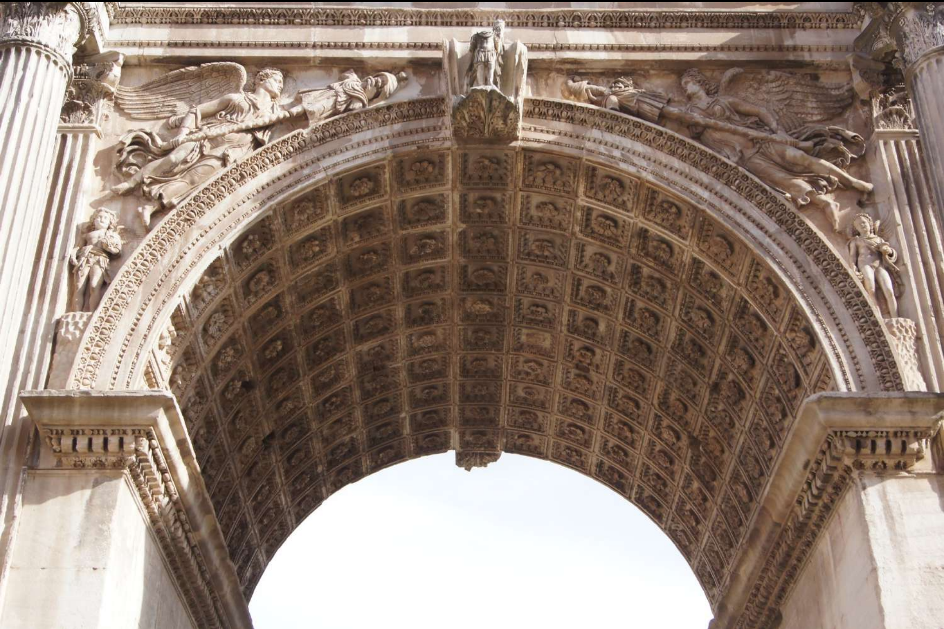
Rom, Triumphbogen des Septimius Severus: kassettierte Tonne (Steinmetzarbeit vom Gerüst aus ausgeführt)
