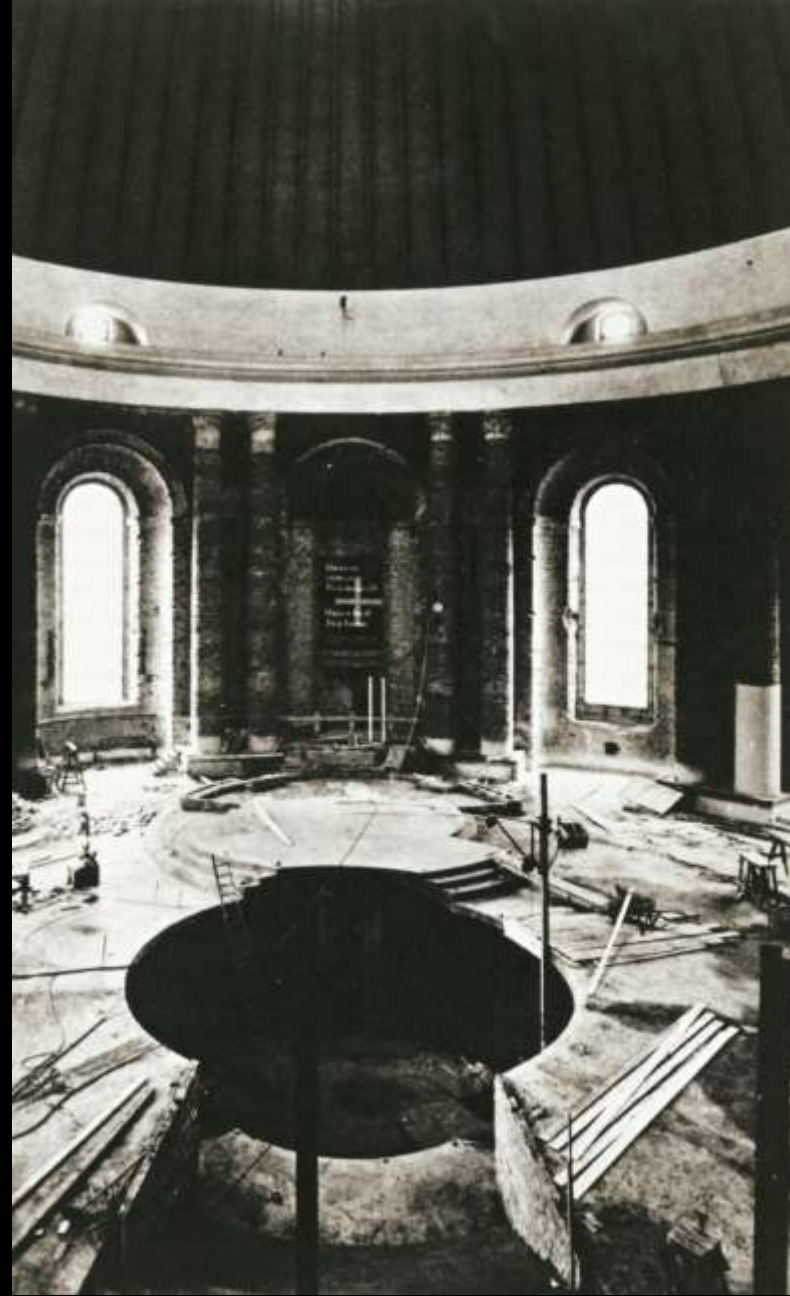
Berlin Hedwigskathedrale, Modell von Hans Schwippert 1952 und Baustelle Mitte der 1950er Jahre (Buslei-Wuppermann 2018)
