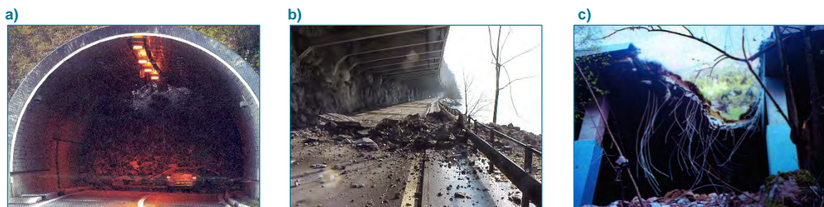
Abb. 35 Steinschlagereignisse 2003; a) Chüebalmtunnel der A8 bei Iseltwald BE, b) Steinschlagschutzgalerie Axenstrasse der A4 am Ölberg Süd SZ, c) Lawinenschutzgalerie Ripplistal der A2 bei Gurtellen UR
