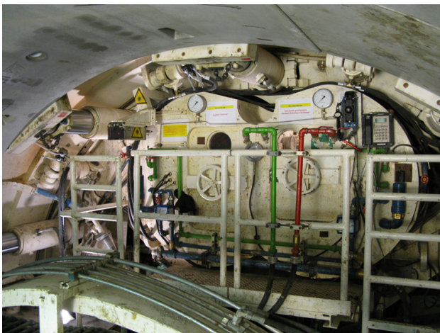
Abb. 14: Personenschleuse mit Eingangskammer (links) und Hauptkammer (rechts)
