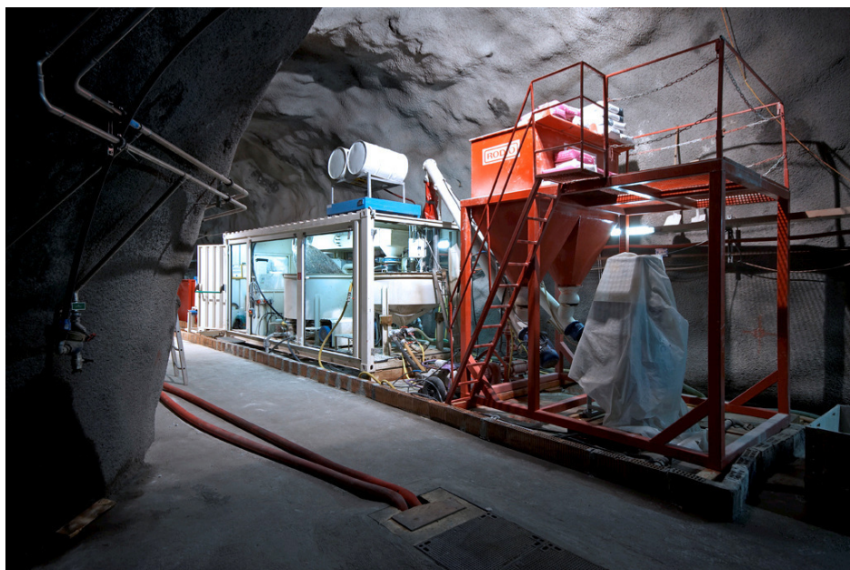
Misch- und Injektionszentrale in der Kaverne
