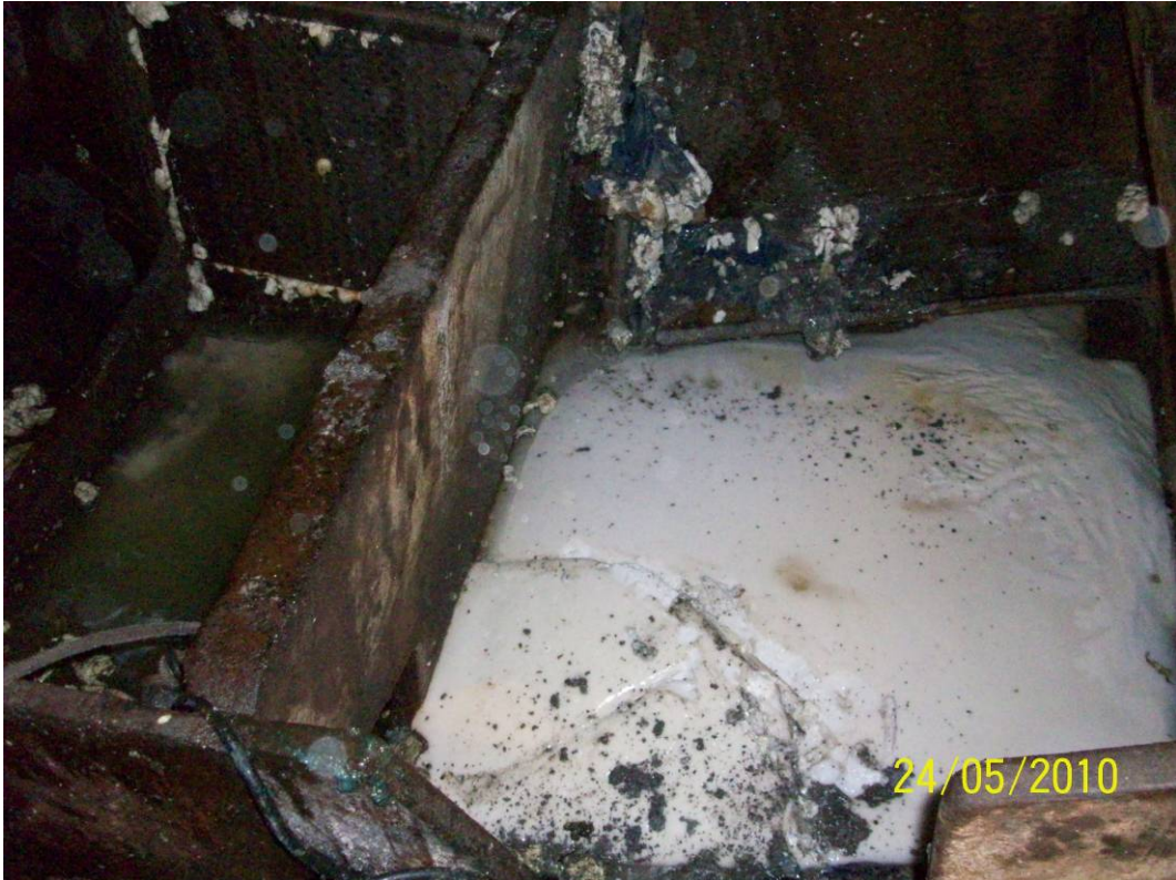
Bild 8: Ausgetretenes Gel in den TBM Bohrkopf; TBM West
