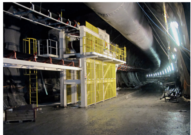
9 Boosterstation im TBM-Vortrieb Booster station in the TBM drive
