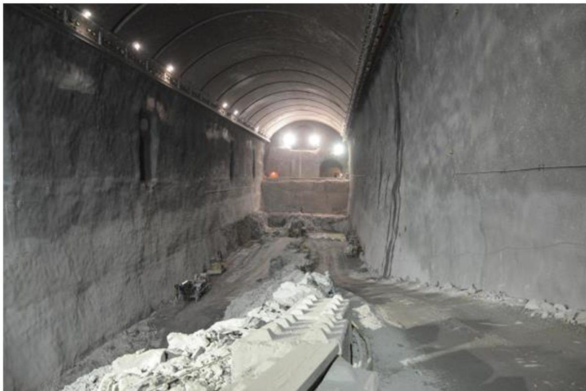
Vue générale de la caverne des machines (KMA)
