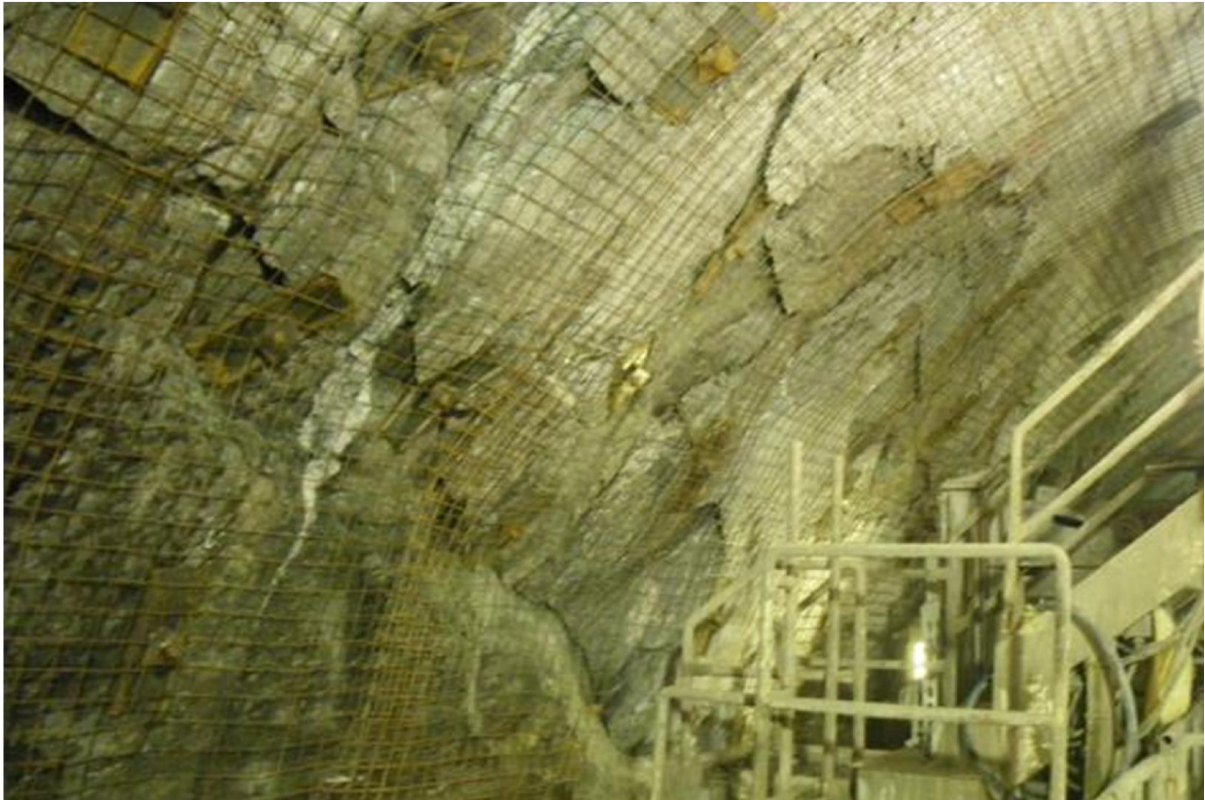
Flambage de couches en parement gauche de l'excavation au tunnelier
