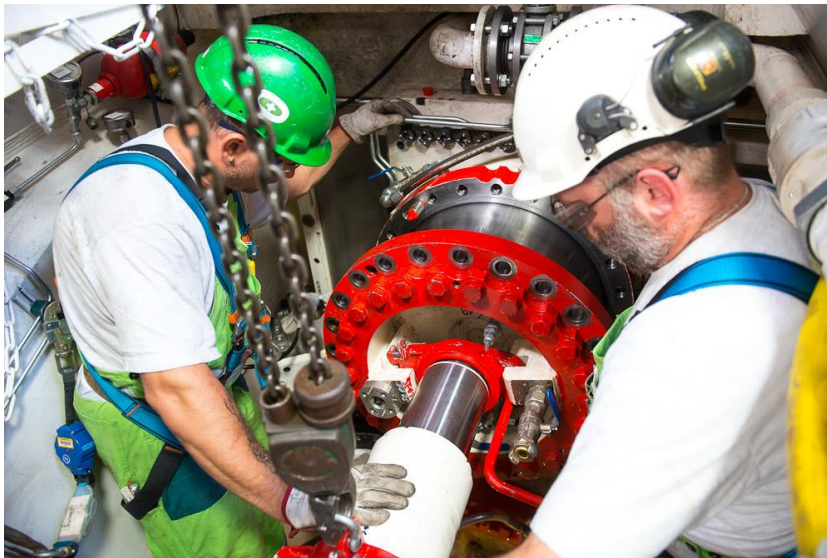
Bild 8 Test und Training für Schneidrollenwechsel innerhalb des Schneidrads während der Inbetriebnahme der TBM
