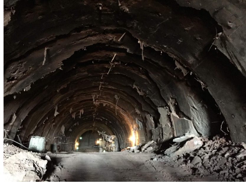
Stark beschädigter Zugangstunnel
