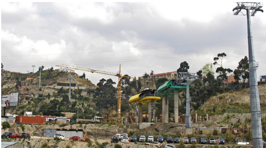
Bild 4: Baustelle der Station „El Libertador“, an der sich Gelbe und Grüne Linie treffen.
