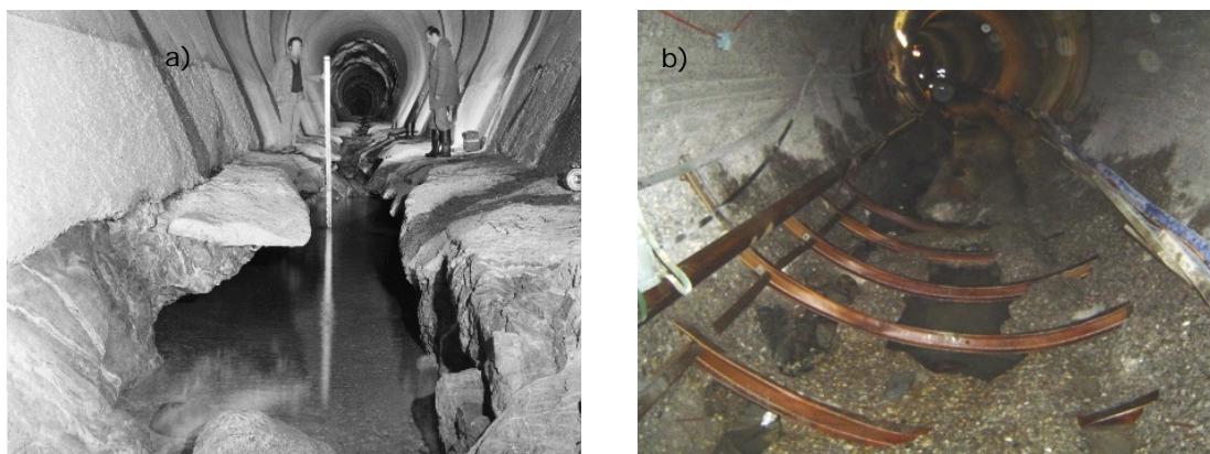
Abb. 3: a) Mehrere Meter tiefe Abrasionsrinne im SBT Palagnedra nach einem Jahrhunderthochwasser (IM Maggia); b) Freigelegte Stahlträger im SBT Val d'Ambra (AET)
