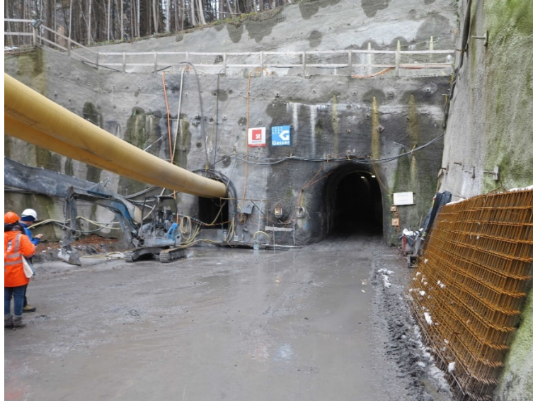
Abb. 30: Besichtigung der Schachtbaustelle des Kraftwerks Berschnerbach im Herbstsemester 2017 mit 9 Studierenden der Studiengänge Bau- und Umweltingenieurwissenschaften.
