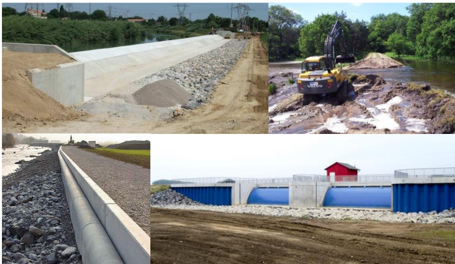
Abb. 15 Mögliche Bauweisen einer seitlichen Entlastung. Oben links: Ungesteuerte Entlastung, ausgeführt als Streichwehr, am Fluss Lez bei Lattes (Degoutte, 2012), unten links: Ungesteuerte Entlastung mit Kippelmenten an der Engelberger Aa (Bezzola und Hegg, 2008), oben rechts: Bedingt gesteuerter Flutpoldereinlass, ausgeführt als Deichöffnung mittels Baggerung, am Havelpolder Schafhorst (LfU Brandenburg, 2014), unten rechts: Gesteuertes Einlassbauwerk des Flutpolders Ingelheim am Rhein (Struktur- und Genehmigungsdirektion Süd, 2006)
