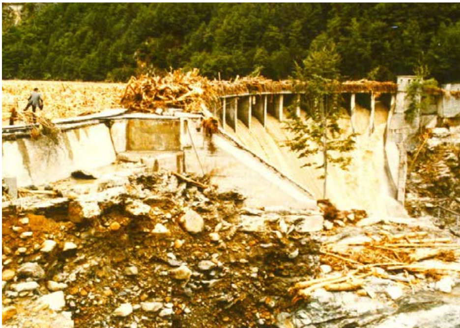
Abb. 1: Schwemmholz an der Talsperre Palagnedra (1978)
