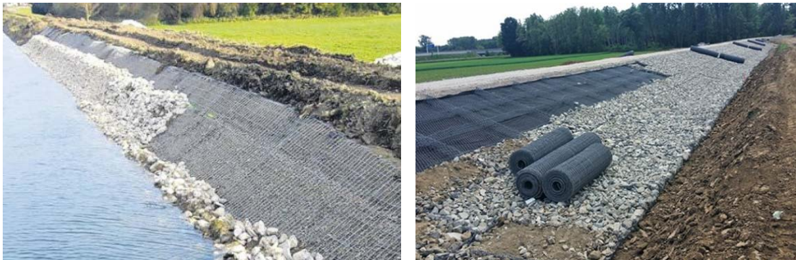
Abb. 1: Massnahmen gegen Biberaktivitäten an Längsdämmen (Quelle: www.sgs-geotechnik.at )
