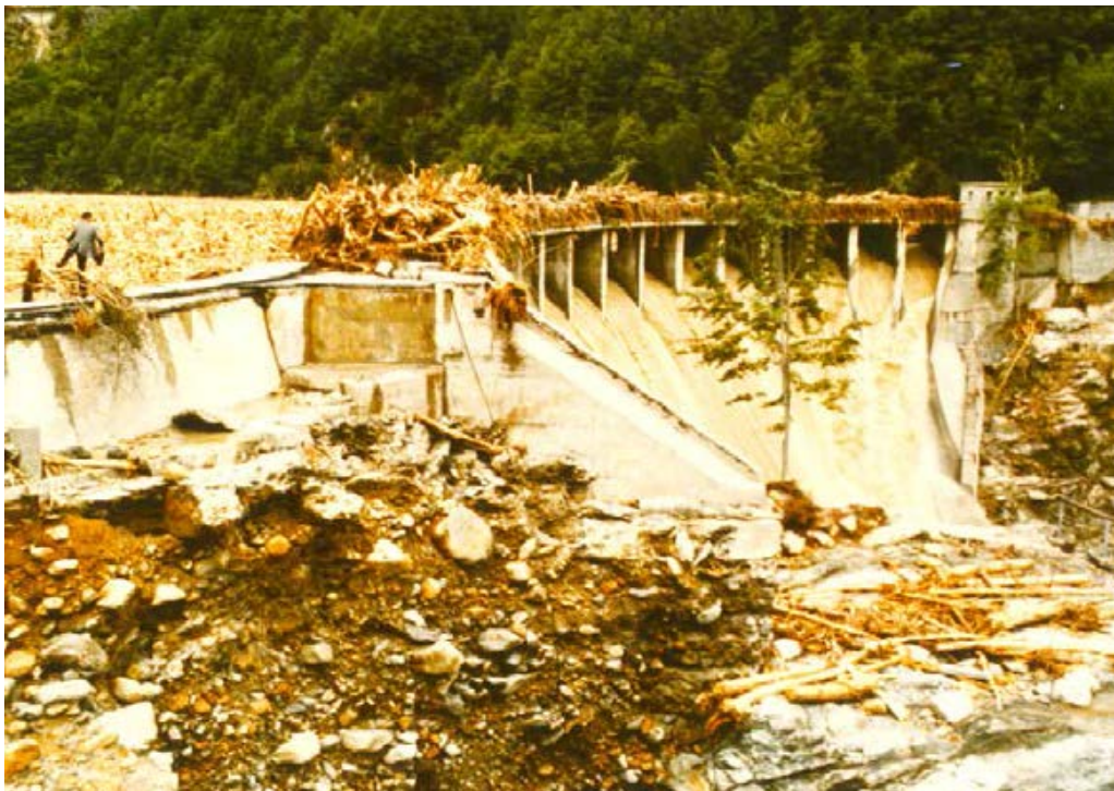
Abb. 1: Schwemmholz an der Talsperre Palagnedra (1978).
