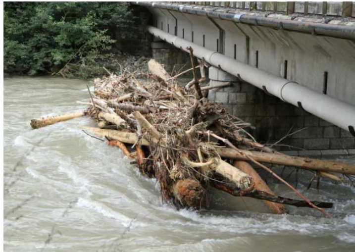
Abb. 1: Schwemmholzverklausung an einem Brückenpfeiler (Quelle: Tiroler Tageszeitung)
