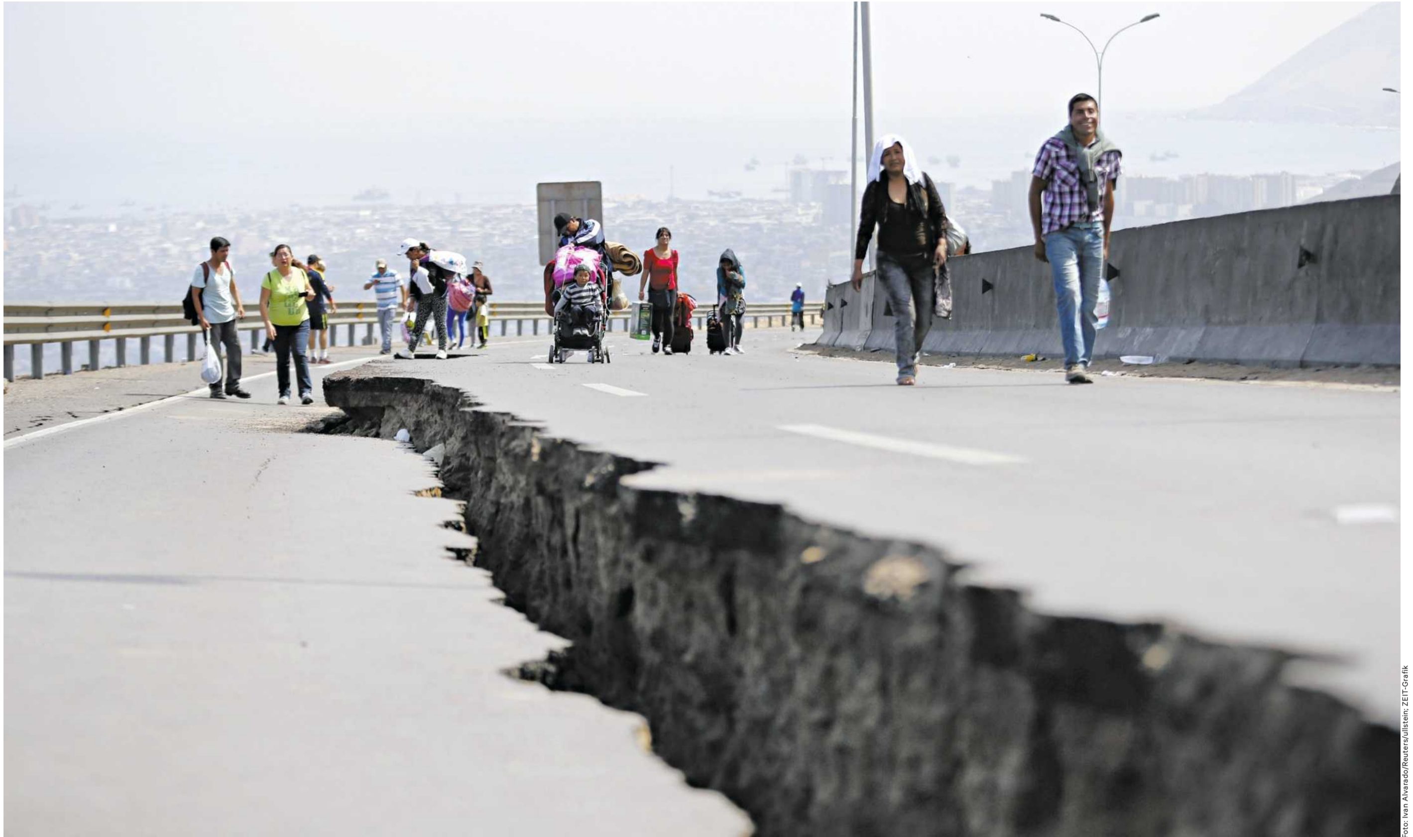
Straße bei Alto Hospicio in Chile, nach einem Erdbeben der Stärke 7,6 im April 2014
