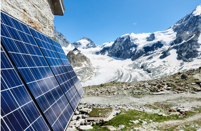
Photovoltaik an den Wänden einer Berghütte in den Schweizer Alpen als alternative Energiequelle.
